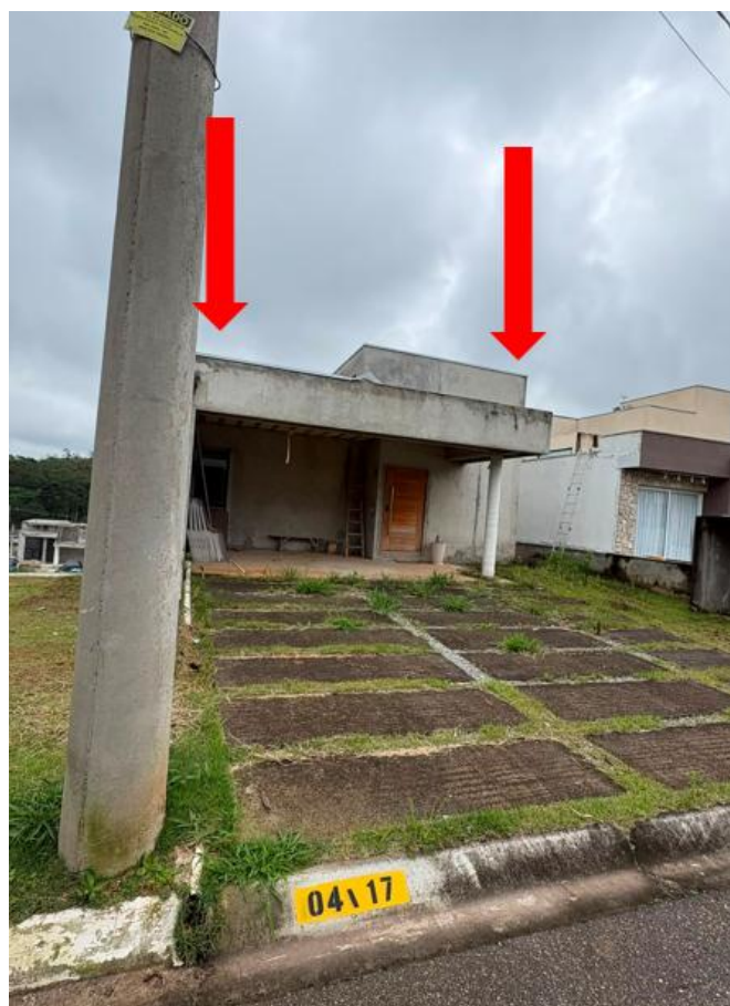
Figura 5 – Vista frontal do imóvel a partir da via, evidenciando volumes construídos e superfícies sem pintura.
